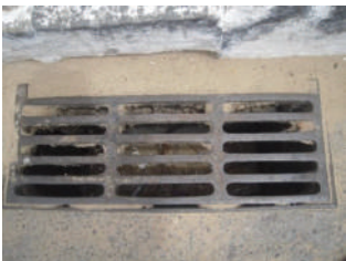
Coleta de águas pluviais/conjunto de bocas-de-lobo
