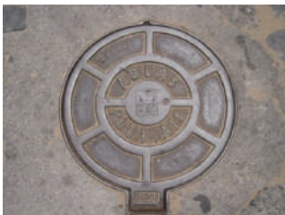
Poço de Visita (PV) para águas pluviais - PMAB
