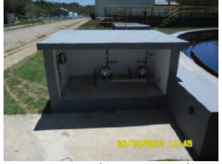
Estação elevatória para ETA reuso
