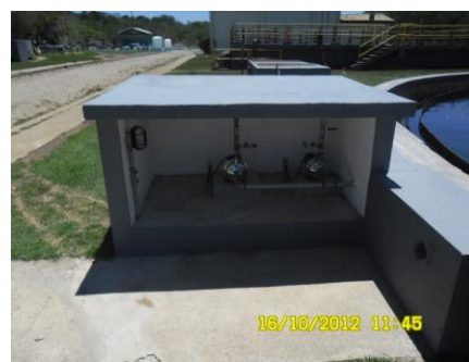
Estação elevatória para ETA reúso
