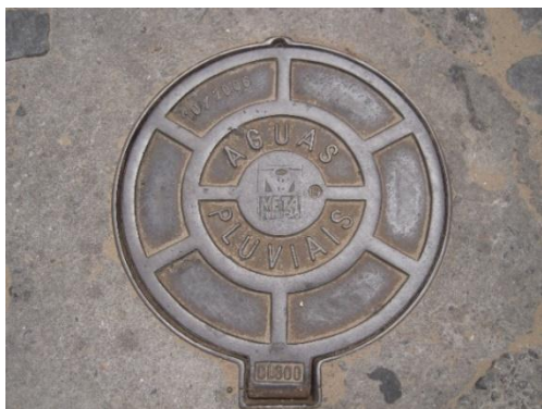
Poço de Visita (PV) para aguas pluviais - PMAB
