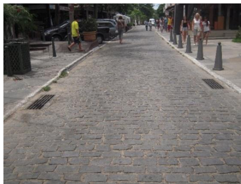
Coleta de águas pluviais/conjunto de bocas-de-lobo
