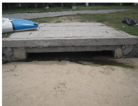
Descarga da lagoa na Praia dos Ossos. Filtro anaeróbio financiado pelo INEA
