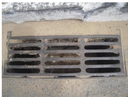
Coleta de águas pluviais/conjunto de bocas-de-lobo
