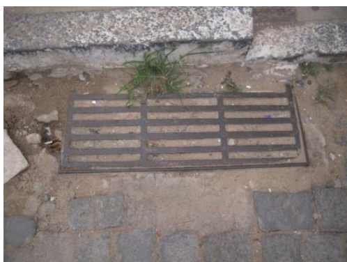
Local com drenagem interceptada para evitar retorno de maus odores
